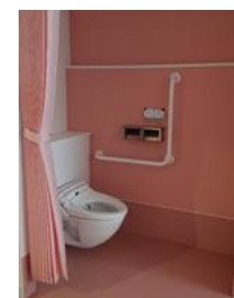
居室内トイレ
